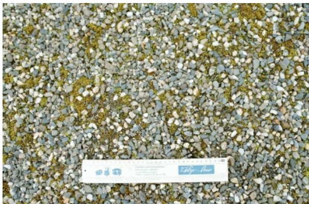
Bild 4.1: Moosbildung in Kiesschicht
