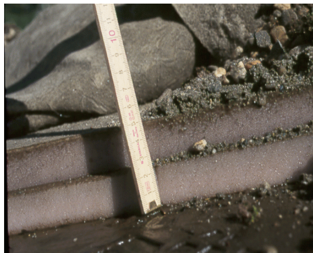
Abbildung 4: Durchfeuchteter Plattenstoss einer entnommenen Dämmplatte
