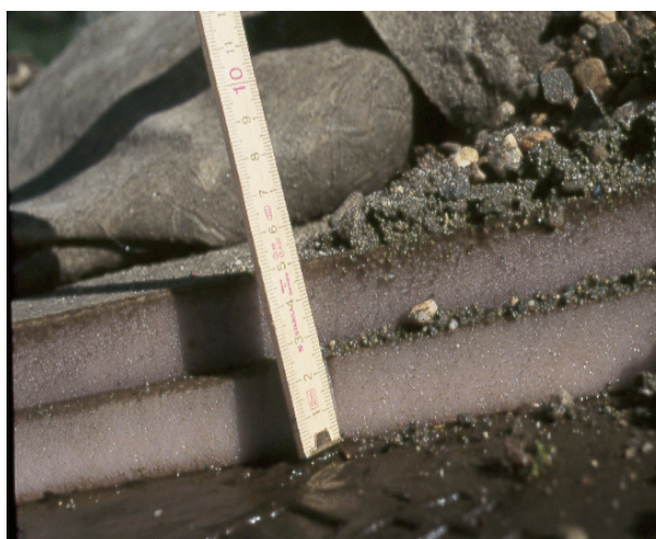
Abbildung 4: Durchfeuchteter Plattenstoss einer entnommenen Dämmplatte
